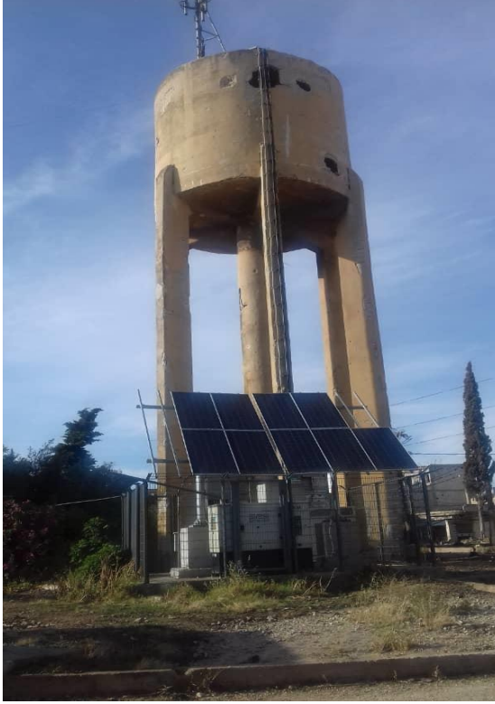
استخدام الطاقات المتجددة لتشغيل الآبار وخدمات الاتصالات - 2020
